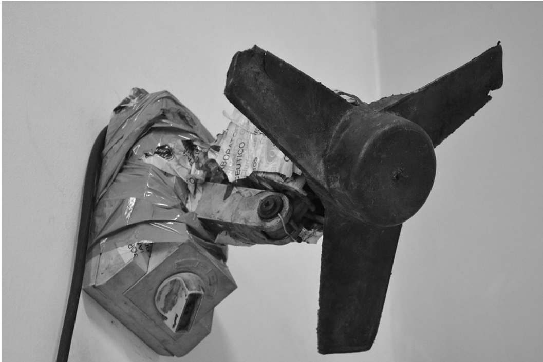
Wall fan, La Víbora, Havana, 2013.
